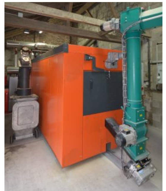
La chaudière HEIZOMAT à Ourscamp, photo FD
