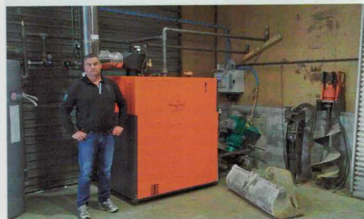
L'entrepreneur Christophe Beaupoil pose à côté de sa chaudière Heizomat RHK-AK 35.
